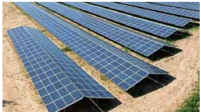
Oost-west georiënteerde panelen
